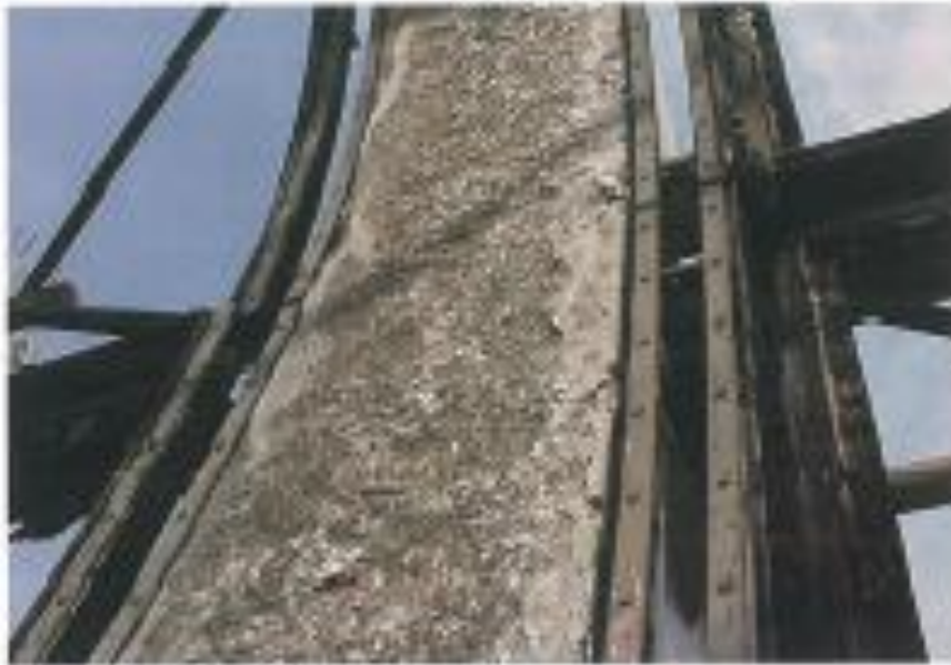
Figuur 2.14 Afgespat beton.
